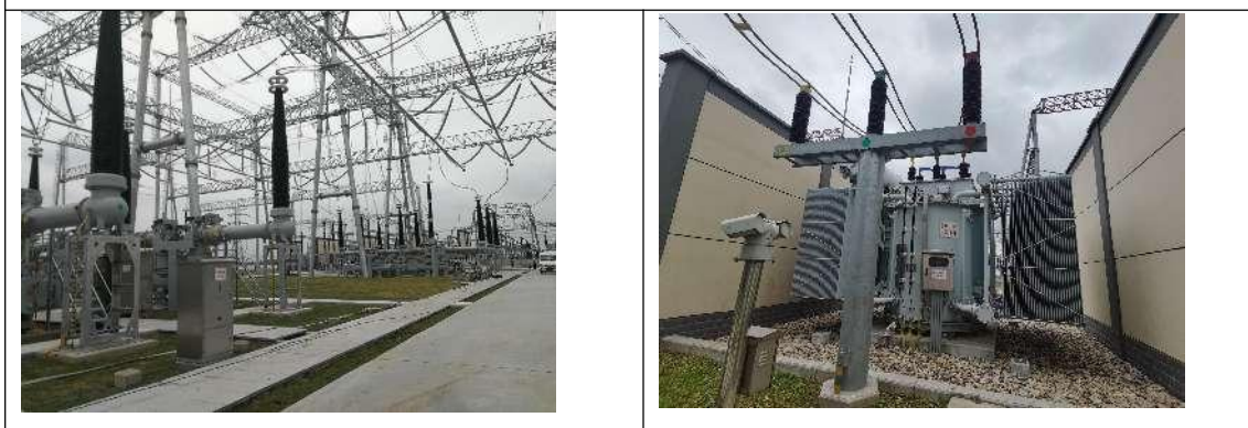
现有 500kV 配电装置 (HGIS)
