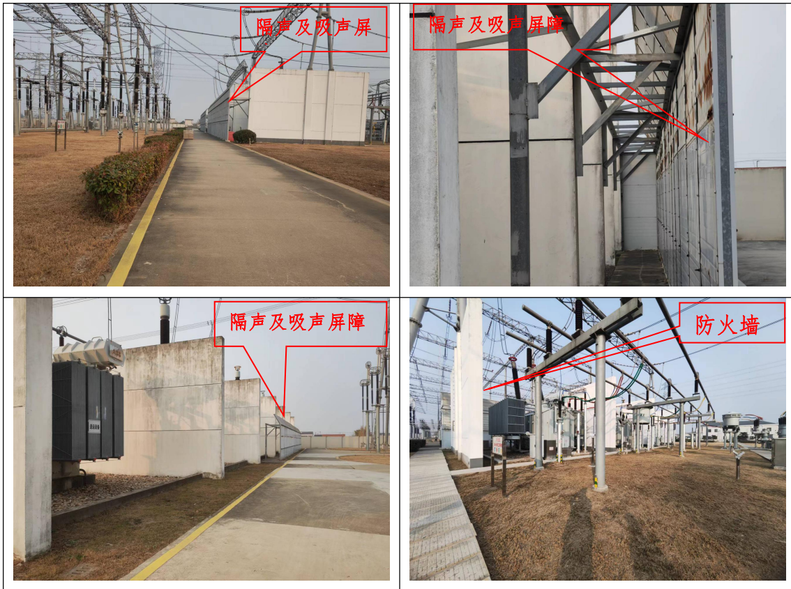
图 3.16 变电站采取噪声控制措施
