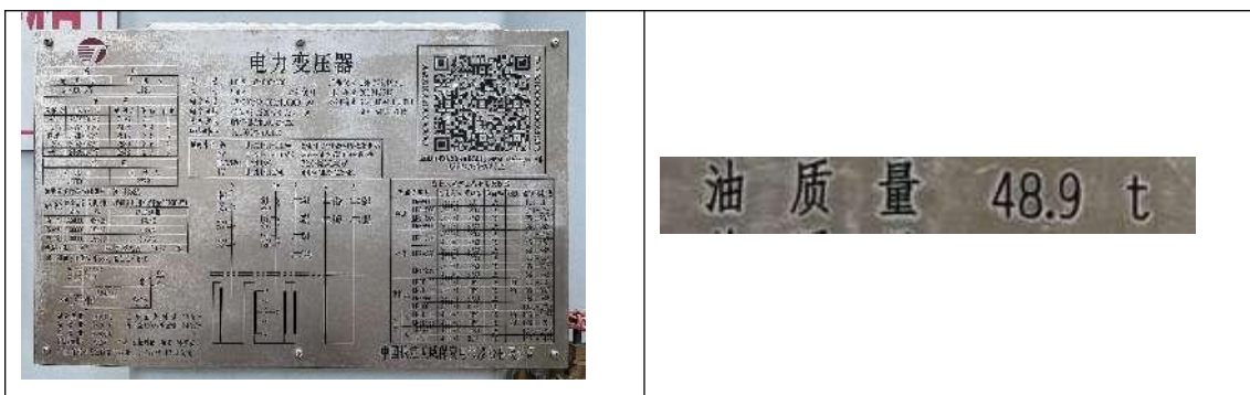
现有#5 主变铭牌（铭牌上未标识噪声水平）
