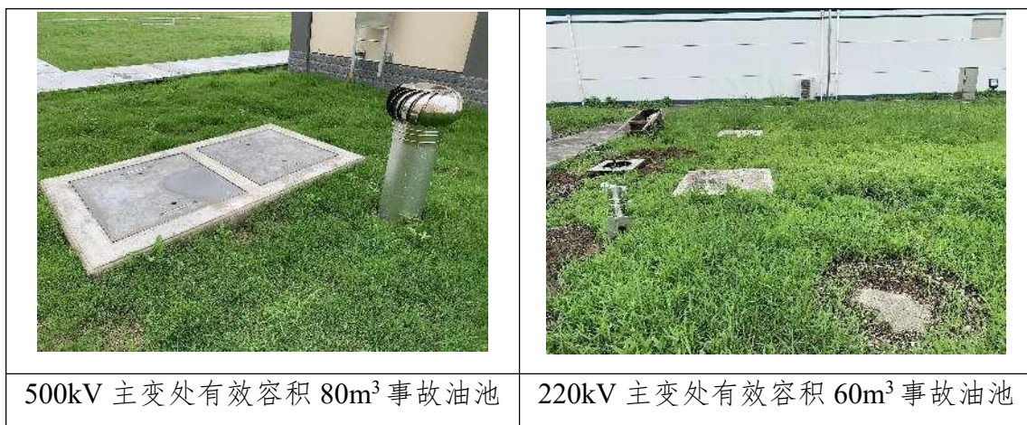
图3.9 新丰500kV变电站设置事故油情况
