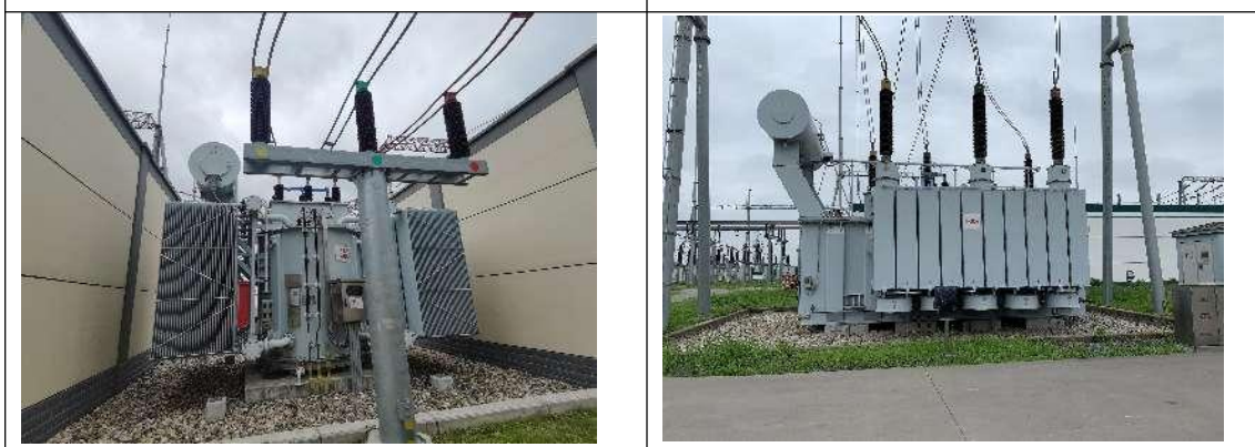
#5 主变 4 号低压电抗器及防火墙
