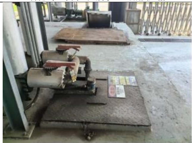
物化线（废切削液清洗废水）-储存池
