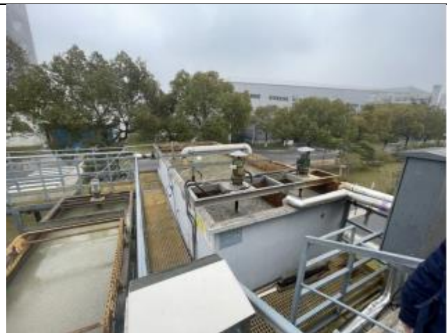
物化线（车间生产废水）-混凝反应槽
