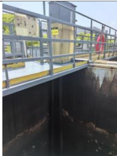
物化线（废切削液清洗废水）-高效油水分离器
