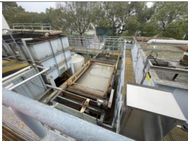
物化线（车间生产废水）-气浮池
