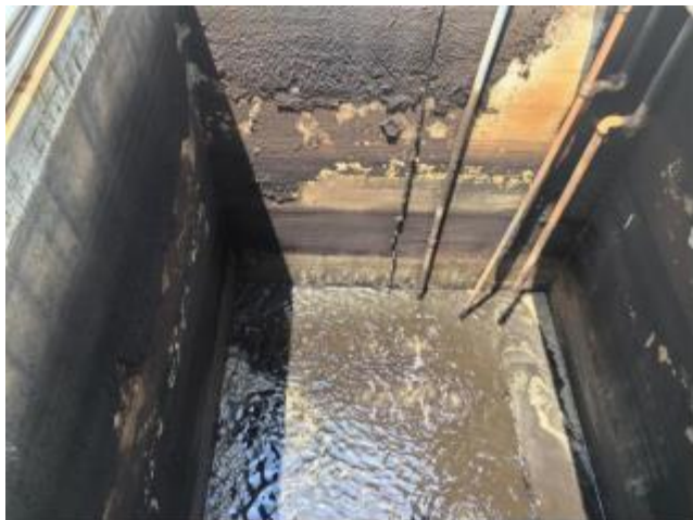
物化线（废切削液清洗废水）-pH 调节池
