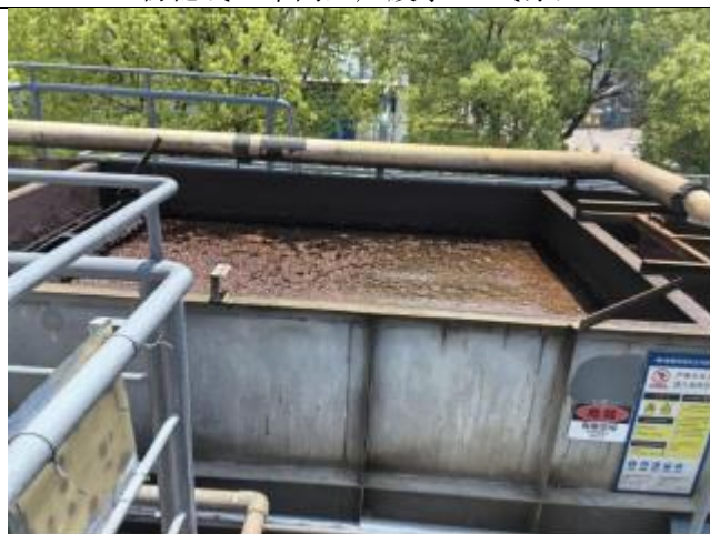
物化线（废切削液清洗废水）-隔渣隔油池
