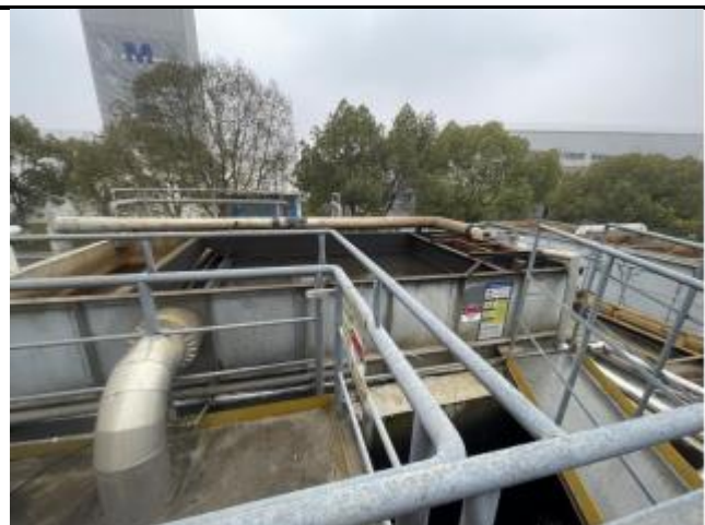
物化线（车间生产废水）-隔油池
