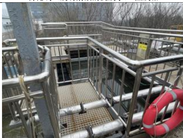
生化线-水解酸化池
