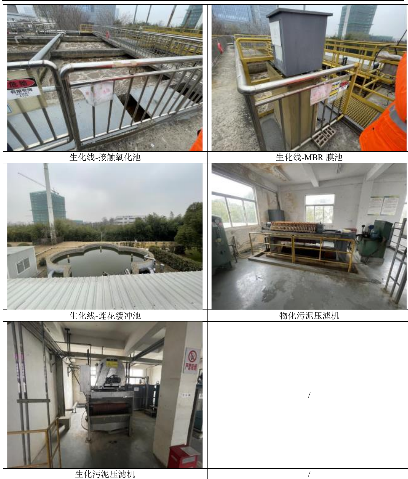
图3.4-3 废水治理设施现场照片
