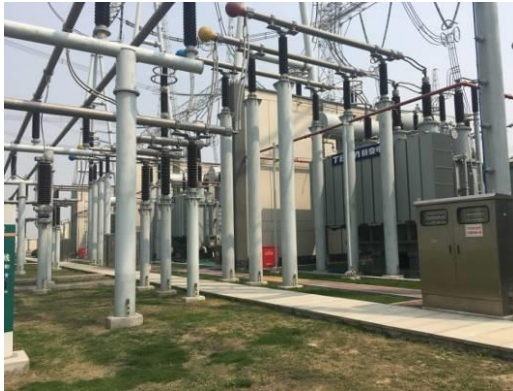
站内已建主变及主变防火墙
