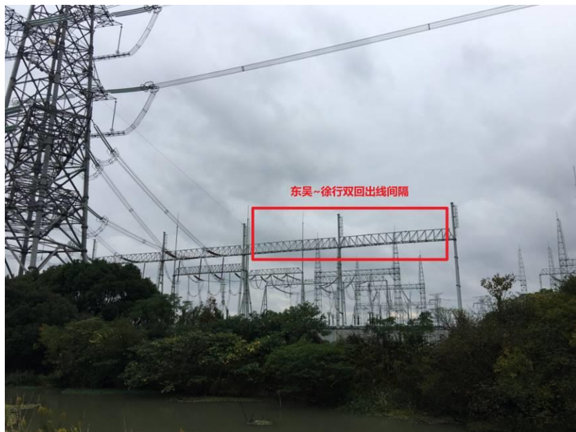
图 3.1-13 扩建至徐行出线间隔照片
