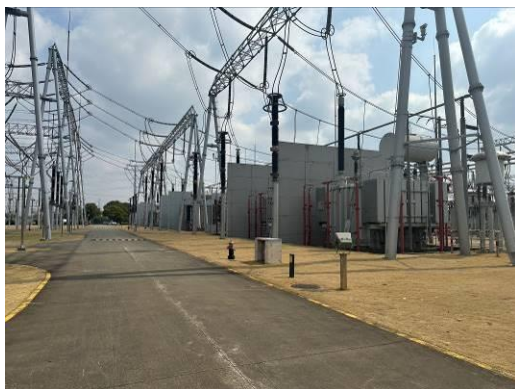
站内已建主变及主变防火墙
