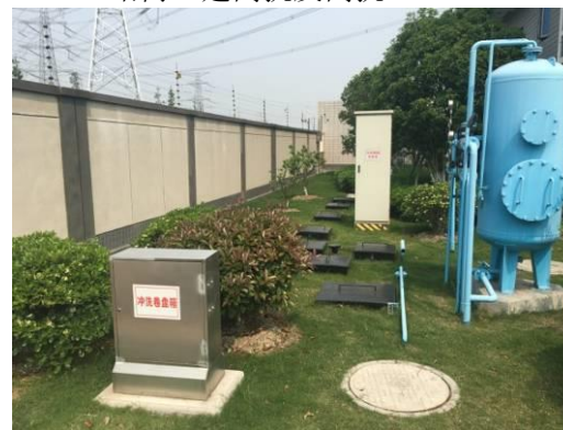
污水处理装置
