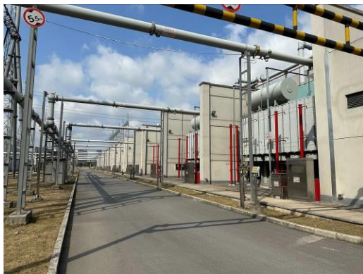
站内已建主变及主变防火墙
